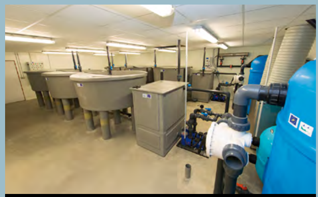
Deux circuits fermés indépendants composés chacun de trois bassins d'élevage et de leurs différents filtres à eau
