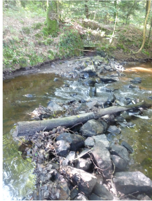
Photo 14 : Seuil en partie démantelé
