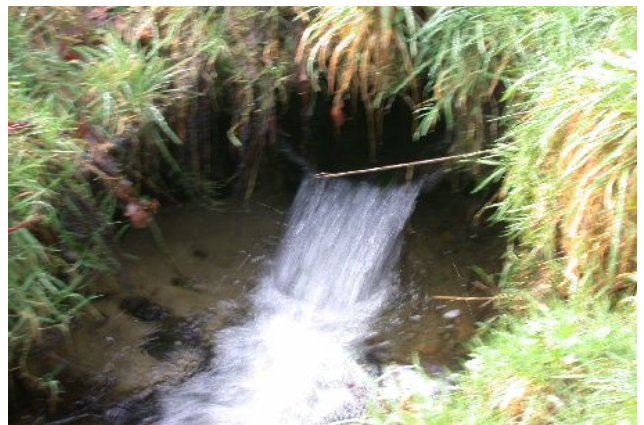
Obstacle à la continuité écologique : buse sur le Hoaz Glaz
