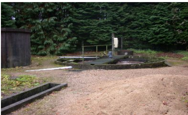
Station d'épuration de La Feuillée
