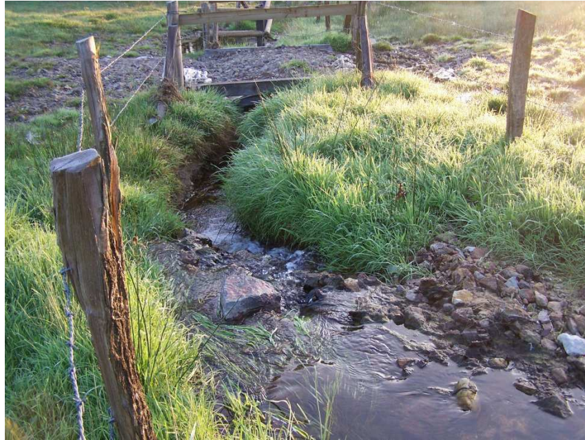
Seuil engendré par les crues de 2014 avec érosion de berge préoccupante en amont rive gauche du pont hydrotube
