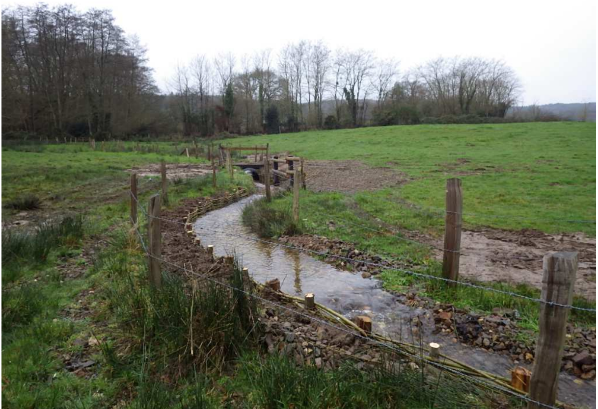
Mise en dérivation d'un étang sur le ruisseau du Chenelaire
