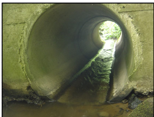
Avant aménagement – Buse difficilement franchissable
